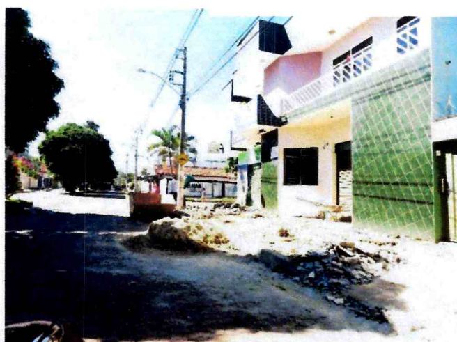
Figura 48- Construções com material impedindo ou dificultando escoamento de água. Infração ao Código de Posturas - Art. 29.
