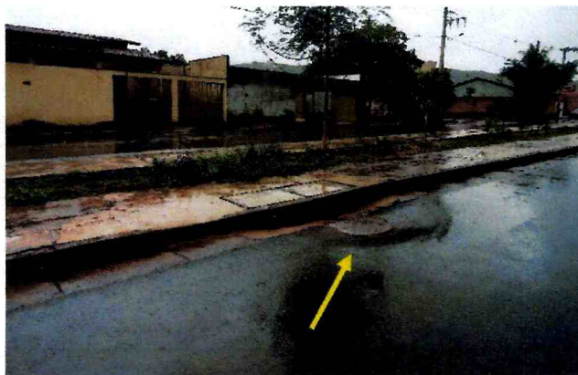
Figura 54-Parte da rua cedendo podendo causar problemas de drenagem e acidentes a população.
