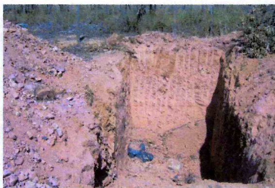
Figura 40-Deposição dos resíduos gerados no tratamento do esgoto.
