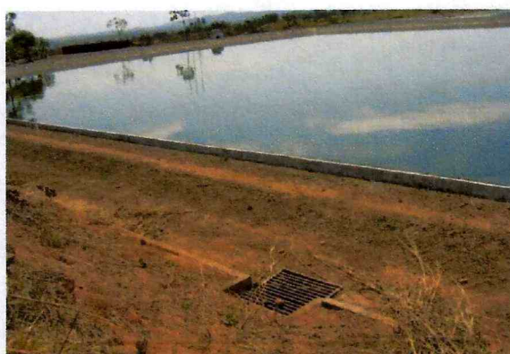
Figura 36- Dispositivo de coleta de águas pluviais (boca de lobo).
