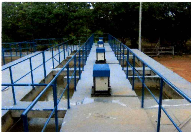
Figura 10-Visão geral das quatro câmaras de floculadores.
