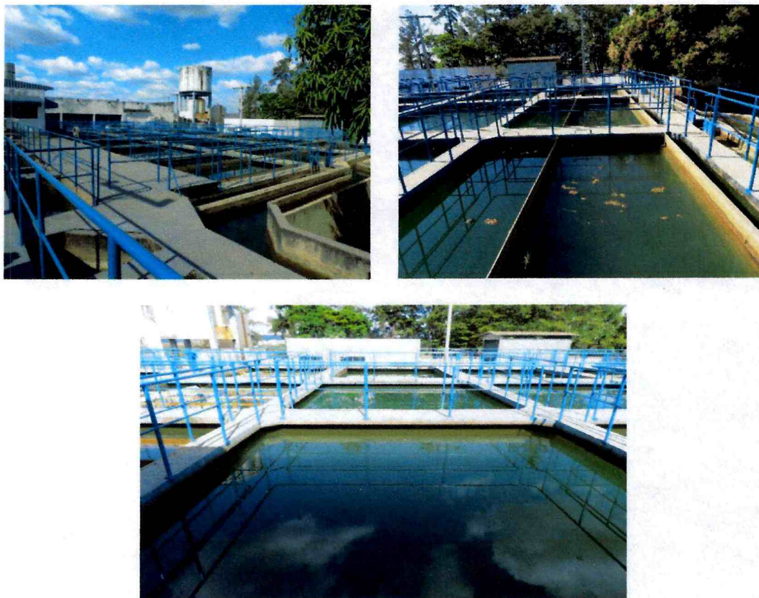
Figura 13-Visão geral dos decantadores.
